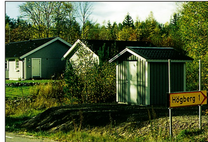
Pumpstation som smälter in i omgivande miljö.
